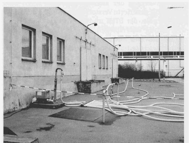
Abbildung 11: Versuchsanlage zur Bodenbelüftung
